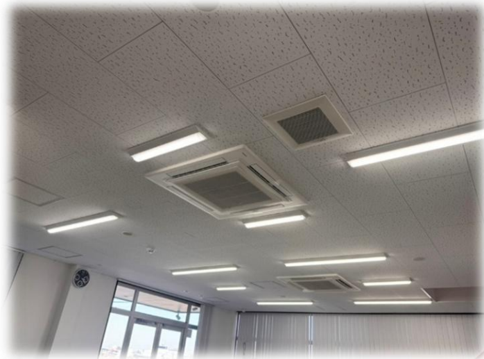
【切替済みの LED 照明】
