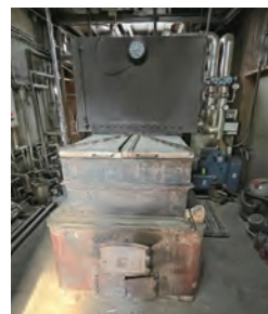
湯を沸かすボイラー
