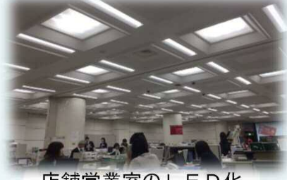
店舗営業室のLED化
